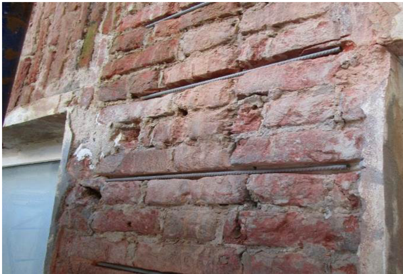
Илл. №4 Установка арматуры в кладочный шов. Предварительное заполнение штробы сложным раствором обязательно!
