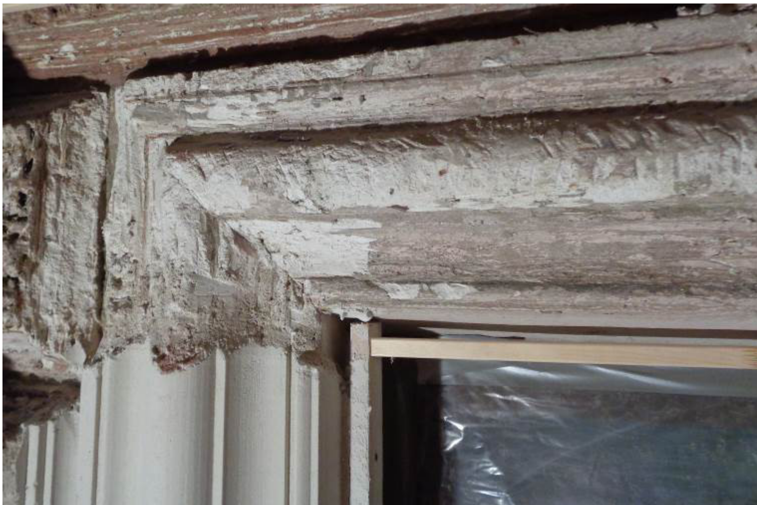
Илл. 7 Скалывание поверхности с утраченным профилем, укрепление остова и протягивание накрывочной штукатуркой.
