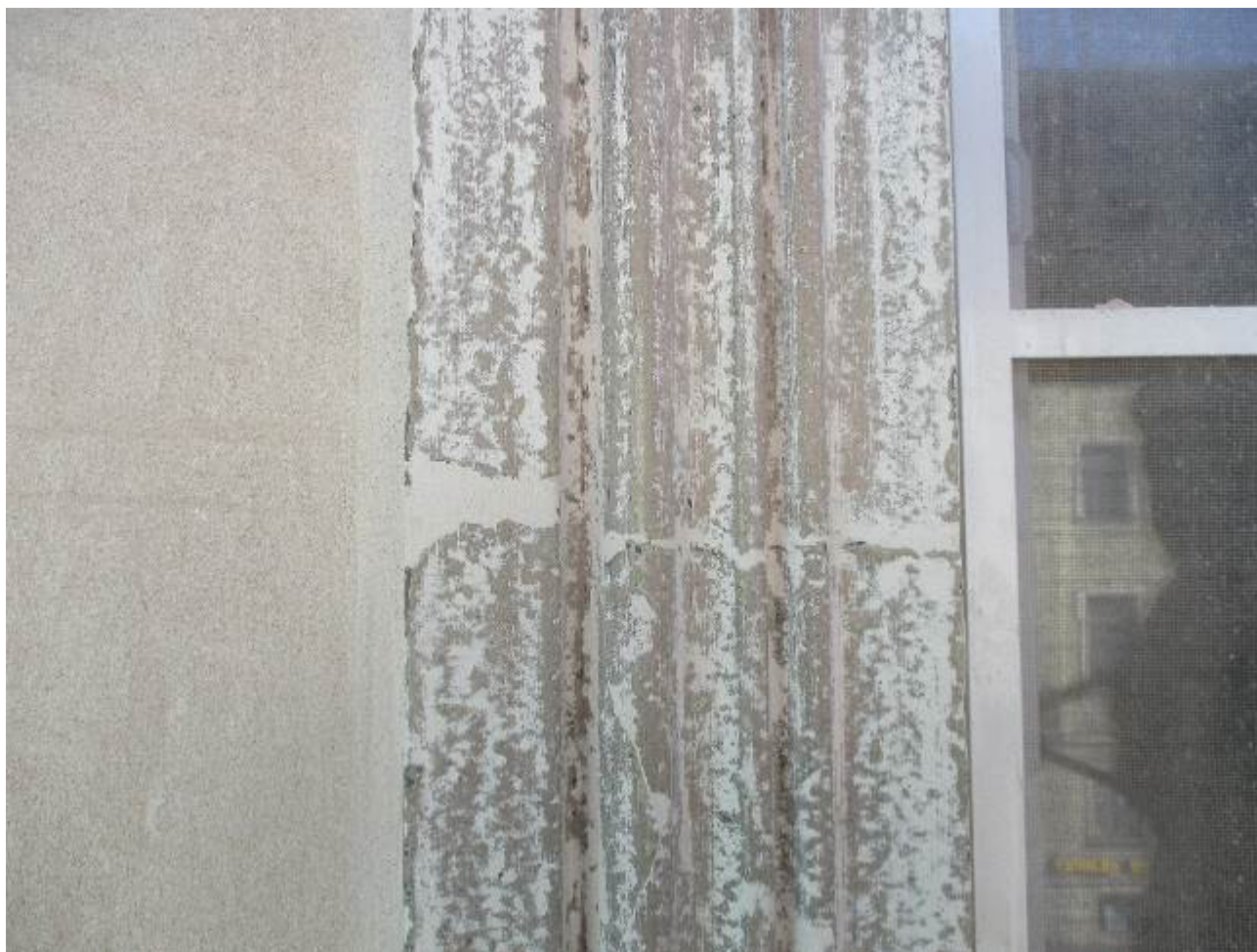
Илл. 6 Заделка мелких дефектов профилированного элемента мелкозернистой шпатлевкой с зачисткой до состояния на сдир
