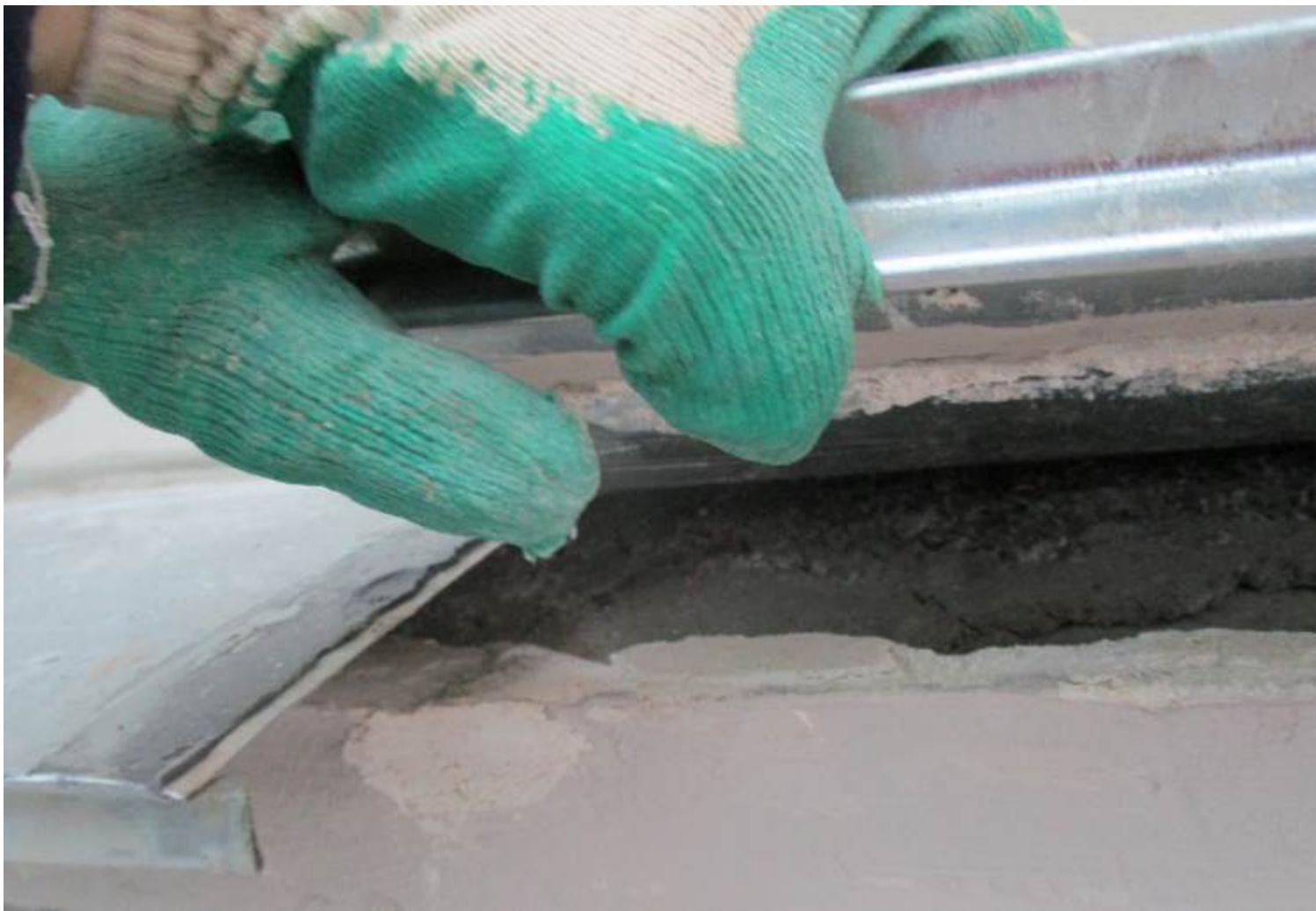
Илл. 18 Недопускаемое «прищипывание» зазора между штукатурным полем, стяжкой и линейным окрытием
