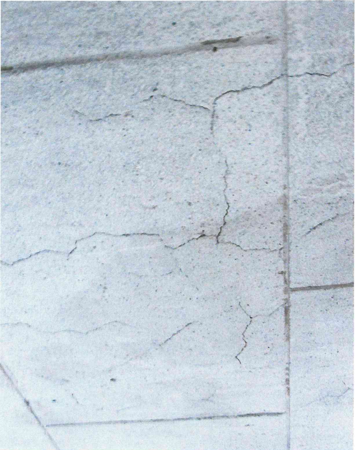
Илл. 4 Высокая трещиноватость поверхности декоративной штукатурки, требующая адгезионного грунтования составом с кварцевым песком и полной наклейки новым слоем
