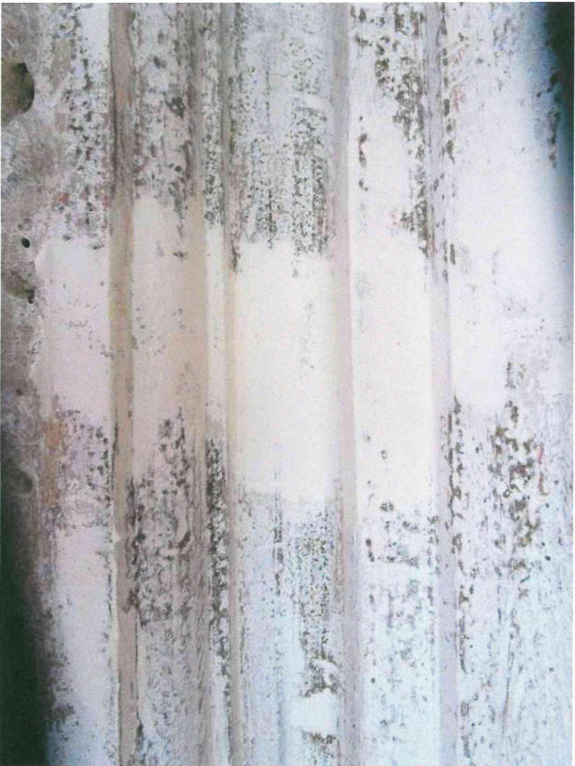
Илл. 7 Заделка мелких дефектов профшипованного элемента мелкозернистой шпатлевкой с защиткой до состояния на сдир
