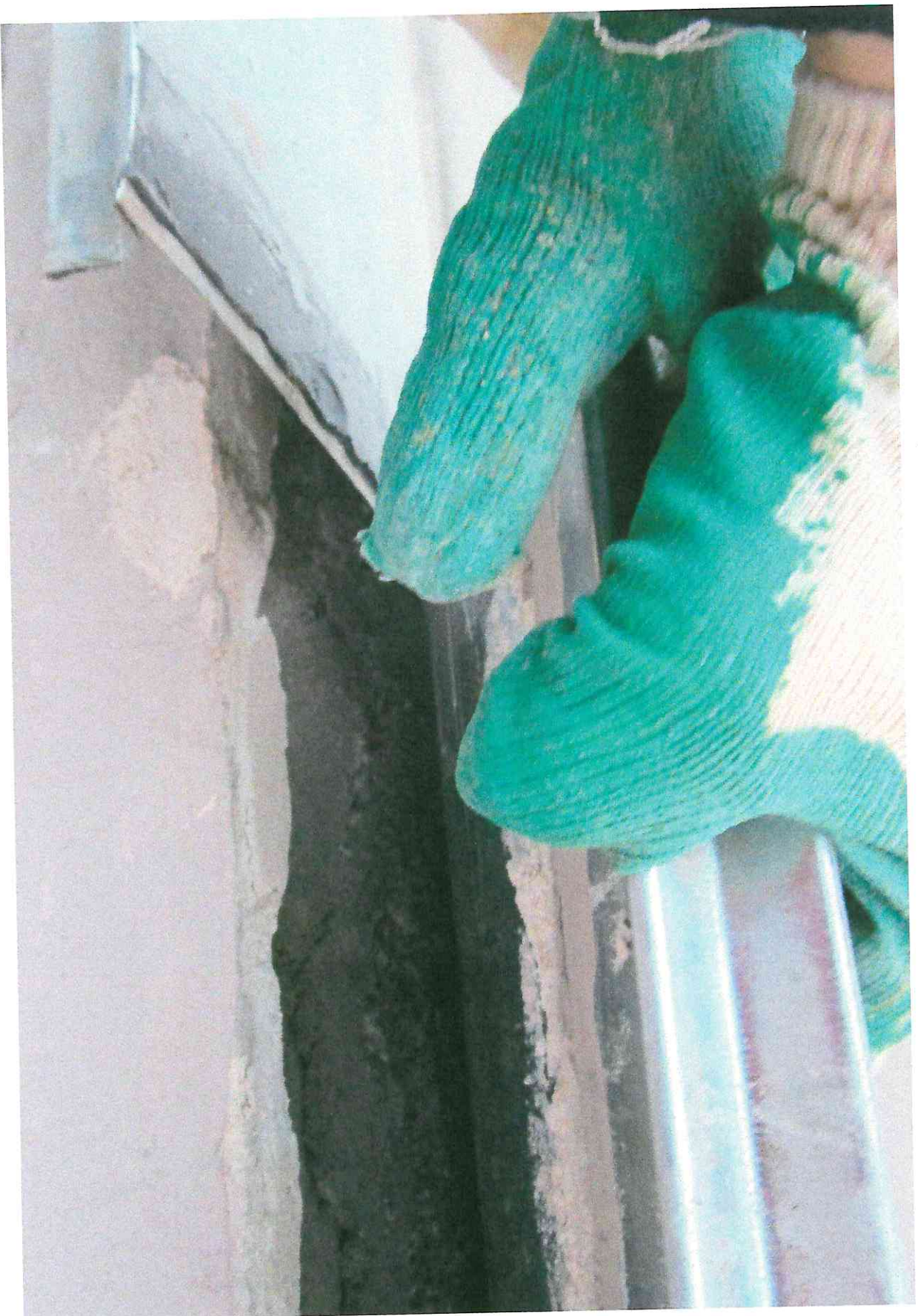
Илл. 21 Недопустимое выравнивание стены под отливом с формированием «корыта» на стяжке
