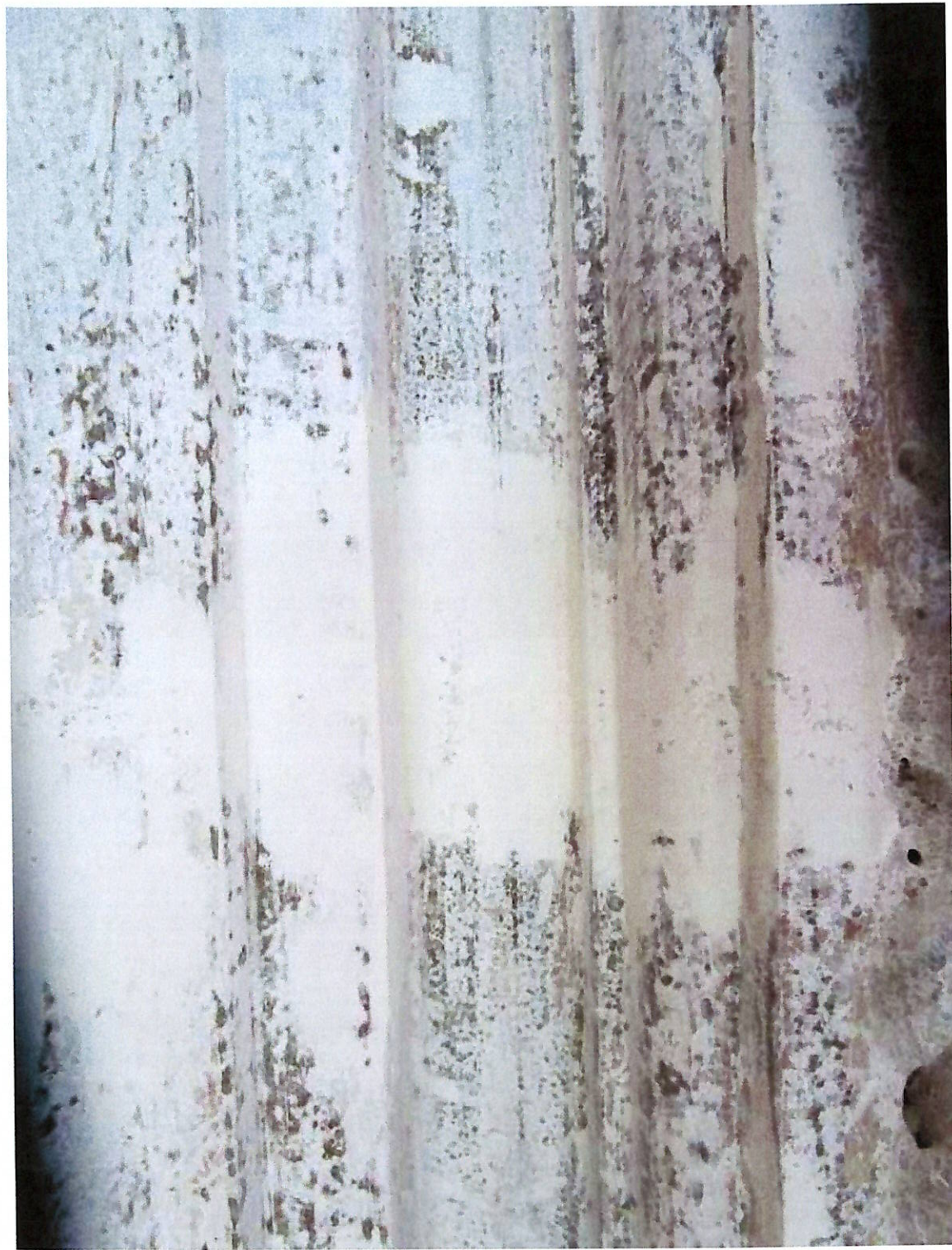
Заделка мелких дефектов профилированного элемента и локальное сглаживание новых и сохраняемых фрагментов тяги мелкозернистой шпатлевкой с зачисткой до состояния на сдир
